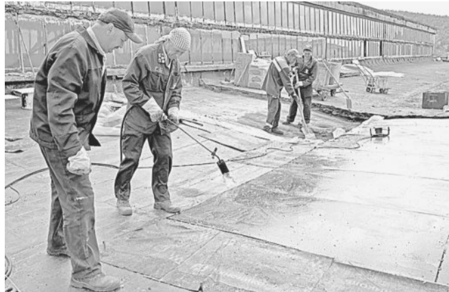
Каменщики Алексей Земсков, Константин Григорьев, электросварщик Игорь Каштанов и маляр Анатолий Шихов реконструируют кровлю МСК-4.
