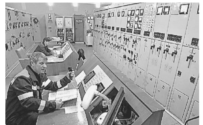
МАТЬ И СЫН. Электромонтёры по обслуживанию электрооборудования электростанций Татьяна и Андрей Васильевы.
